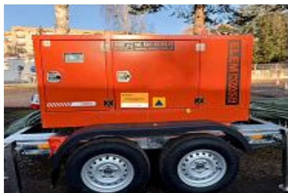
Agregat prądotwórczy (na przyczepie)
